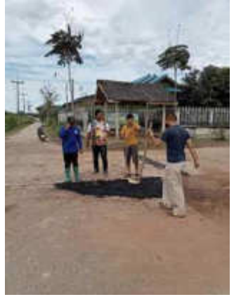
ซ่อมแซมผิวจราจรด้วยวัสดุยาง มะตอย หมู่ที่ ๑๑ บ้านหนองเสม็ด
