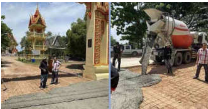
สนับสนุนงบประมาณในการซ่อมสร้างบูรณะวัดราษฎร์นิมิต(หนองปรือ) หมู่ที่ ๑๓ บ้านหนองปรือ
